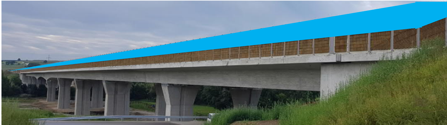
K 36/1: Ersatz der transparenten Elemente durch Alu-Elemente auf Goldachtalbrücke - Foto: ABDS
