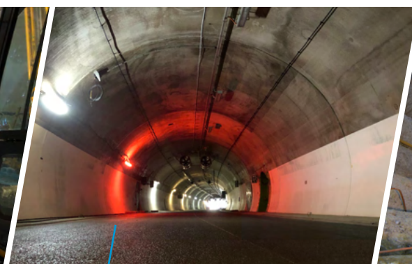
Der Innenausbau der Tunnelröhre ist abgeschlossen. Es folgt der Einbau der Betriebstechnik.
