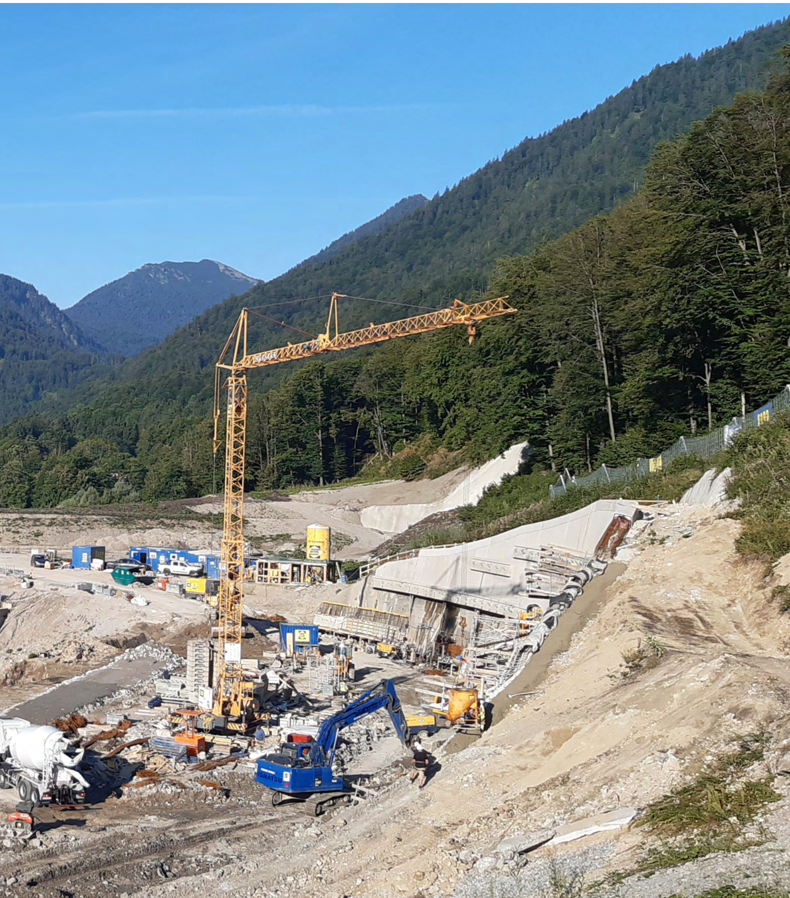
Vor dem Nordportal laufen die Arbeiten zur Fertigstellung der Stützwand zur Hangsicherung sowie der neuen Anschlussstelle Oberau-Nord.
