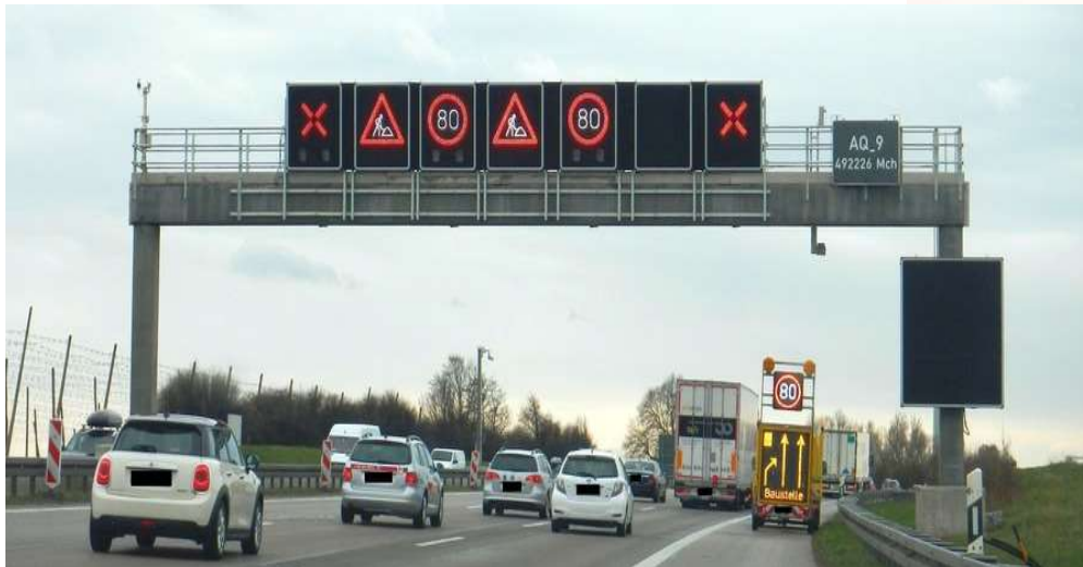
Verkehrsbeeinflussungsanlage A 9 TSF, Foto: Vössing Ingenieurgesellschaft mbH
