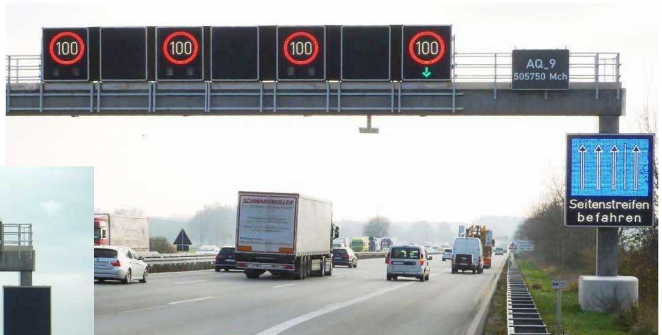
Verkehrsbeeinflussungsanlage A 9 TSF, Foto: Vössing Ingenieurgesellschaft mbH
