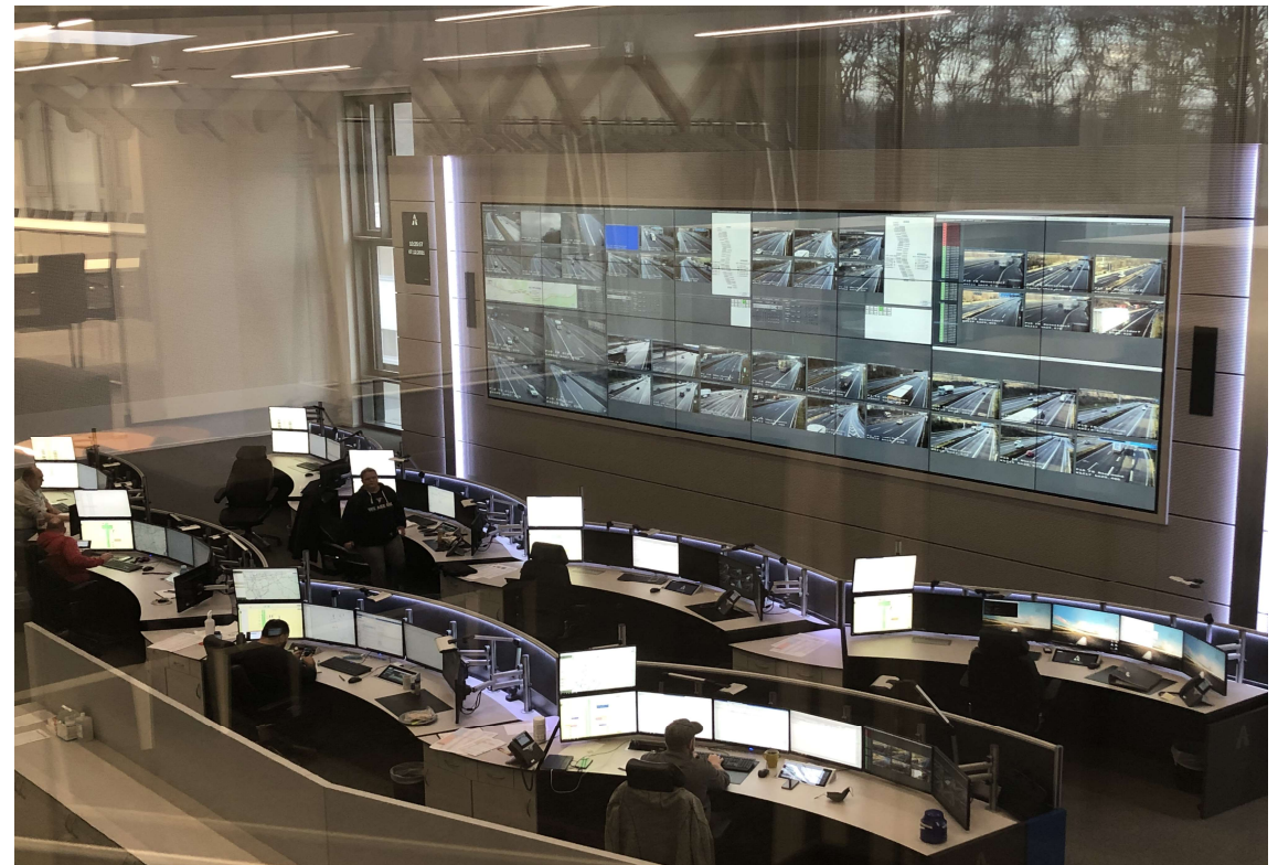
Kontrollraum der Verkehrszentrale in Leverkusen
